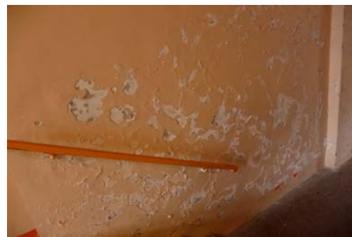
FLOP 3: Der Zustand - Wände, die sich vom Acker machen!
